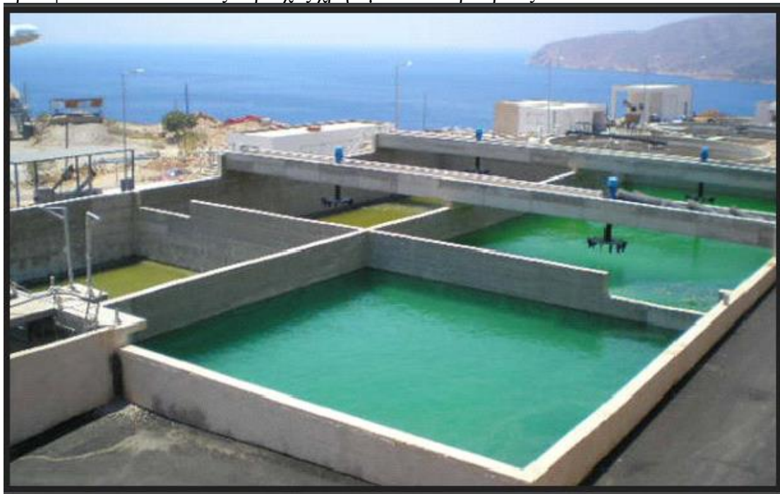
Εικόνα 2-2: Εγκαταστάσεις επεξεργασίας λυμάτων
